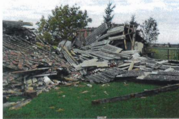
Rys. 3 Ruiny budynku gospodarczo – inwentarskiego po zawaleniu ścian, dachu i stropu. Białczyk dz. nr 508 gm. Witnica. Stan na dzień: 13.09.2011 r. (z archiwum autora)
