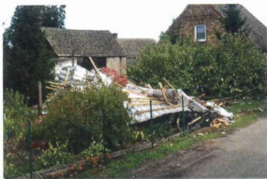
Fot. 10. Dach jednego z budynków w Lubiszynie zerwany i rzucony do ogrodu (widać krokwie o małych wymiarach oraz blachę trapezową). Stan na dzień : 13.09.2011 r. (źródło : z archiwum autora)
