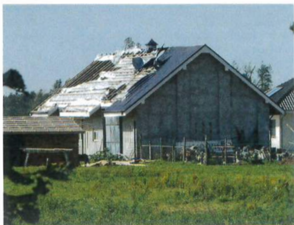
Fot. 4 Zerwane pokrycie dachu i ocieplenie na budynku magazynowo – warsztatowym (przebudowywanym z budynku stodoły). Białczyk gm. Witnica. Stan na dzień 13.09.2011 r. (z archiwum autora).
