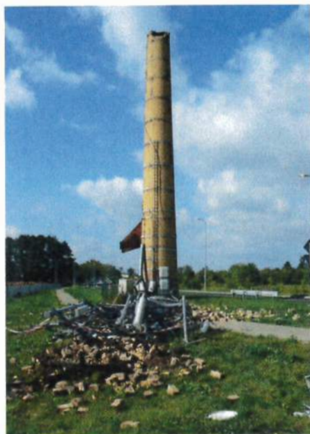
Fot. 1 Widok złamanego i zawalonego komina przy drodze krajowej nr 132 w Witnicy. Stan na dzień 13.09.2011 r. (z archiwum autora)
