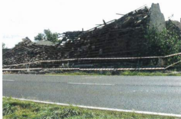
Fot. 2 Ruiny budynku gospodarczo – składowego po zawaleniu ścian, stropu i dachu przy drodze wojewódzkiej nr 132. Białcz dz. nr 295/1 gm. Witnica. Stan na dzień 13.09.2011 r. po usunięciu elementów budynku z drogi wojewódzkiej (z archiwum autora).
