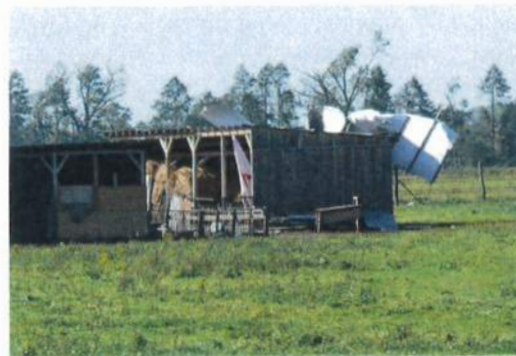
Fot. 11. Zerwany dach wiaty składowej w Białczku. Widoczny jest zerwany dach z krokwiami i zamocowaną blachą trapezową. Stan na dzień: 13.09.2011 r. (źródło : z archiwum autora)
