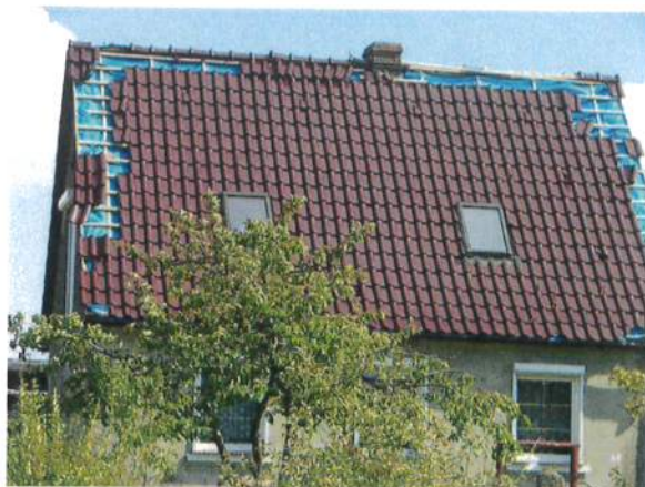
Fot. 6. Budynek mieszkalny z terenu powiatu.. Widoczne są oderwane dachówki na krawędziach dachu i przy kalenicy dachu. Stan na dzień : 13.09.2011 r. (źródło : z archiwum autora)
