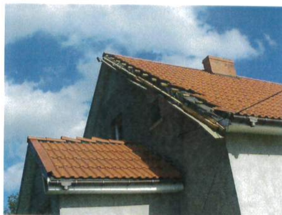
Fot. 7. Budynek mieszkalny z terenu powiatu.. Widoczne są oderwane dachówki na krawędziach dachu i przy kalenicy dachu oraz podniesione gąsiori na dobudówce. Stan na dzień: 16.09.2011 r. (źródło : z archiwum autora)
